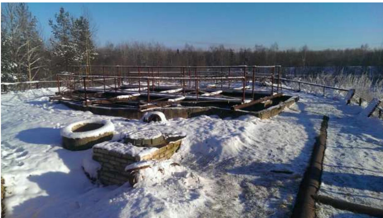
Рисунок 7 - Сборный трубопровод двухъярусных отстойников
