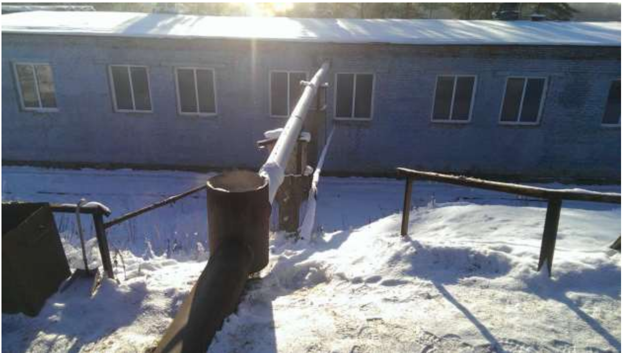
Рисунок 8 - Транспортирующий участок трубопровода от двухъярусных отстойников
